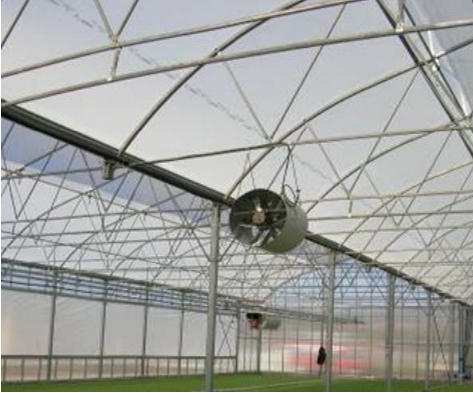
Resim 22 Fan Kontrol Sistemi
