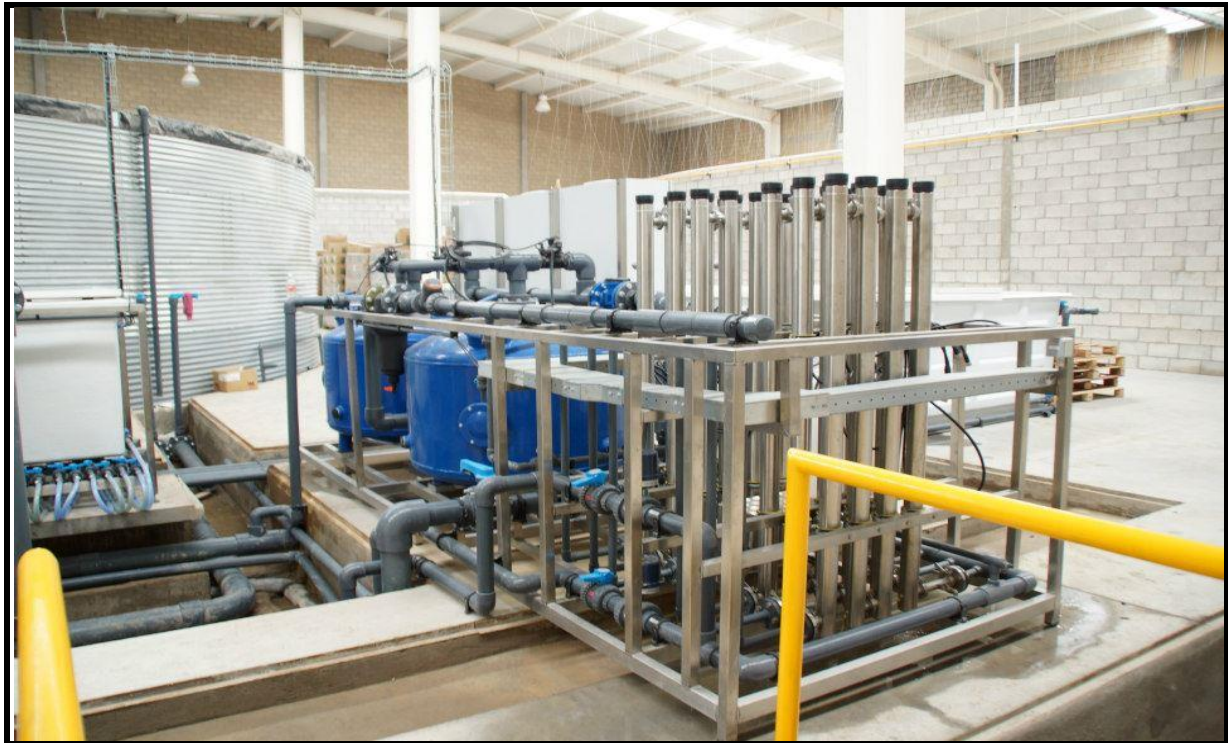
Resim 43 Sulama Filtre Sistemi
