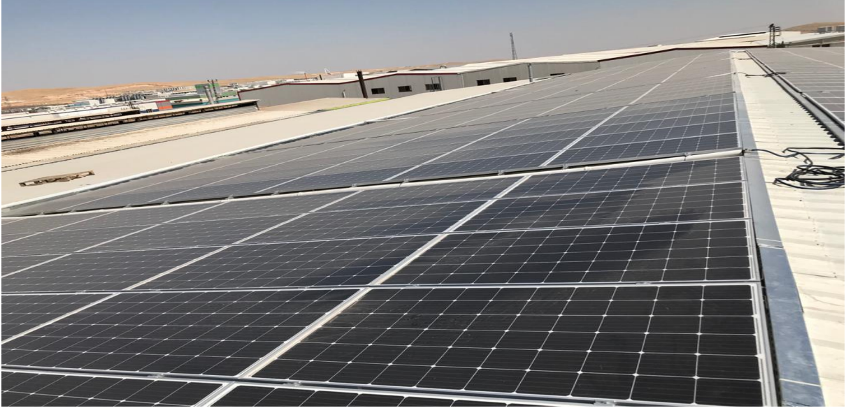
Şekil 4: Güneş Enerjisi Üretimi Yapan Fotovoltaik Enerji Panelleri
