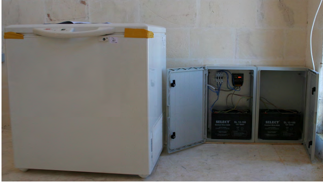
Buzdolabı-Solar kontrol ve batarya Grubu
